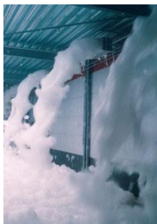
Figuur 5.11 – Lichtschuimsysteem in werking (Inside Air)
