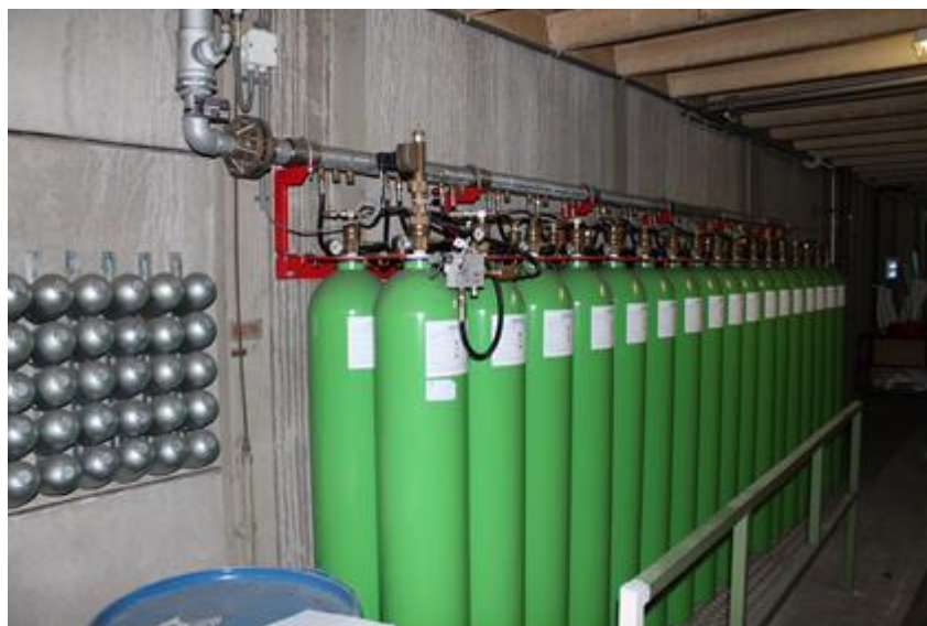
Figuur 5.5 – Inertblusgassysteemopstelling t.b.v. PGS 15-opslag
